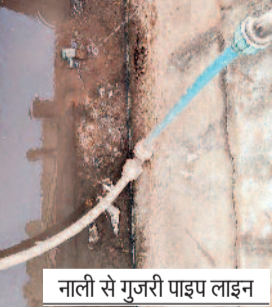
नाली से गुजरी पाइप लाइन
